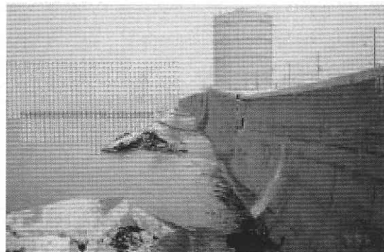
写真2 兵庫県南部地震で被災した淀川堤防
