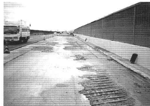
図1 コンクリート床版の損傷状況
