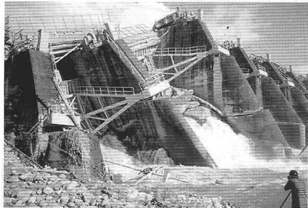
図1 台湾集集地震で断層により破壊した石岡ダム洪水吐:この地点で上下のずれは10mに達している。
