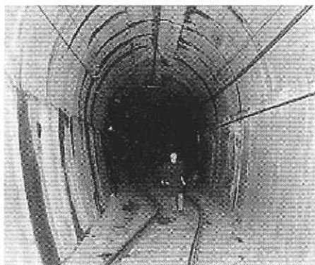
(b) レールのバックリング
