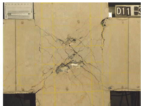
層間変形角 3.0%時
