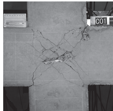
層間変形角 3.0%時
