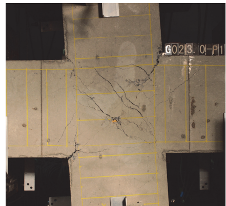
層間変形角 3.0%時
