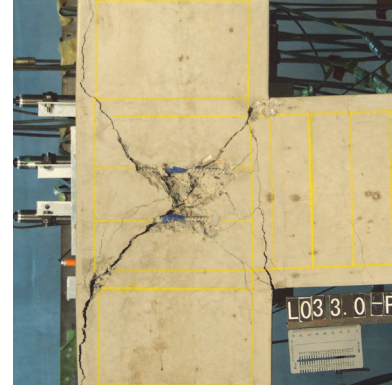
層間変形角 3.0%時
