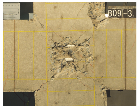
層間変形角 3.0%時
