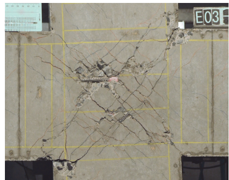
層間変形角 3.0%時
