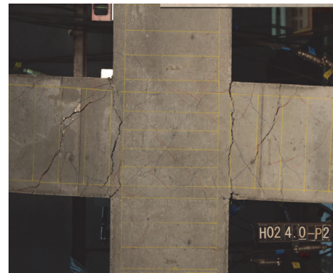
層間変形角 3.0%時
