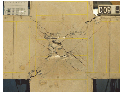
層間変形角 3.0%時
