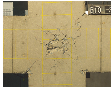
層間変形角 3.0%時
