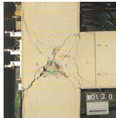
層間変形角 3.0%時
