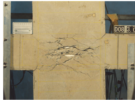
層間変形角 3.0%時
