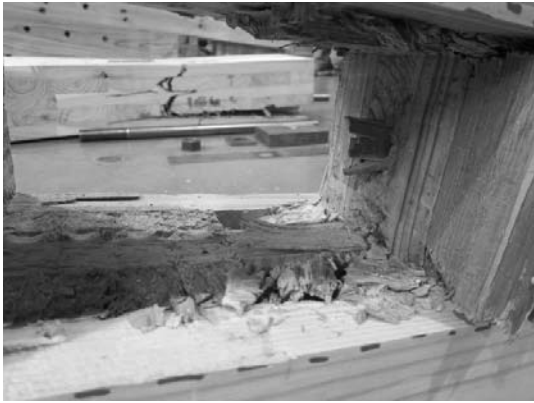
写真 5.4-17 Mx60APS0840-2 解体後 座金下部の圧縮
