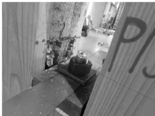
写真 5.4-28 Mx60APS1540-1 座金による圧縮めり込み
