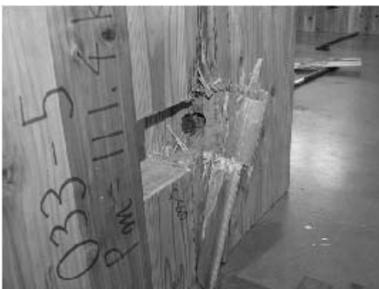
写真 6.4-41 033-5 積層接着面のせん断木部破壊
