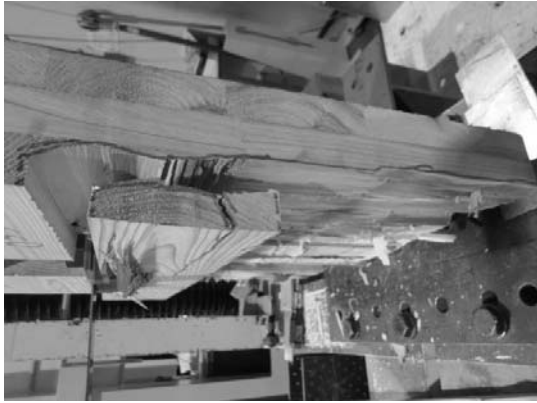
写真 6.4-37 033-3 積層接着面のせん断木部破壊
