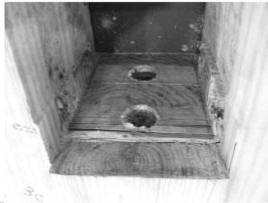
写真 6. 4-20 P55D-1 解体後 座金下部のめり込み
