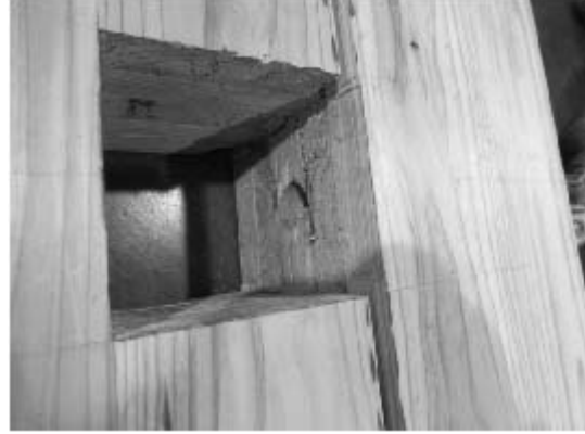
写真 5.4-50 Mx60AOS1520-2 解体後 座金下部の様子 めり込み無し
