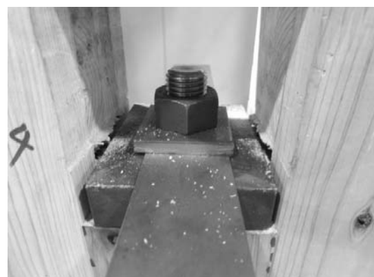
写真 6.4-12 P34-4 座金下部のめり込み
