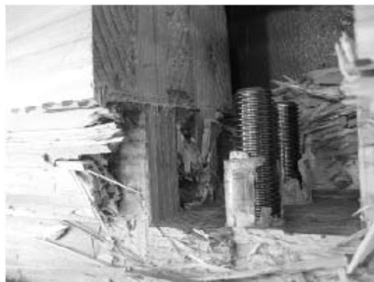
写真 6.4-60 055D-2 解体後 座金下部のめり込み
