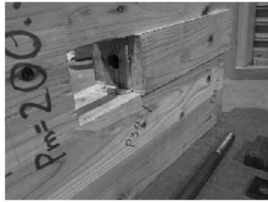
写真 6.4-8 P34-1 積層接着面のせん断木部破壊
