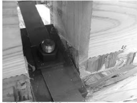
写真 6.4-68 077-1 座金下部のめり込み
