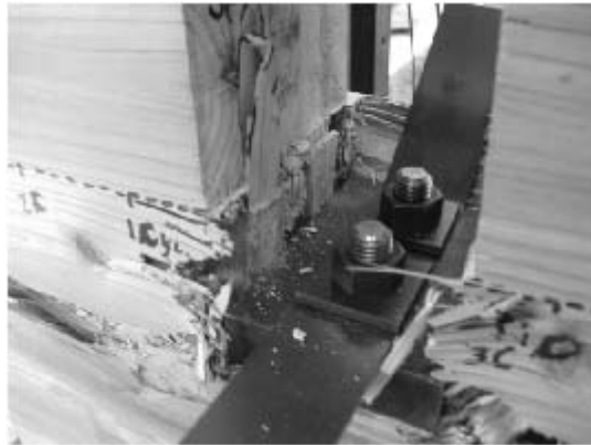
写真 6.4-58 055D-1 座金下部のめり込み
