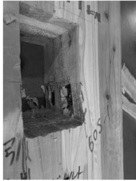
写真 4.4-21 60S-1 座金下部のめり込み
