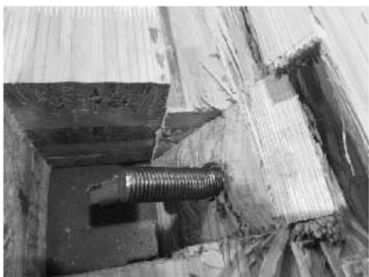
写真 5.4-56 Mx60AOS1540-5 解体後 座金下部のめり込み
