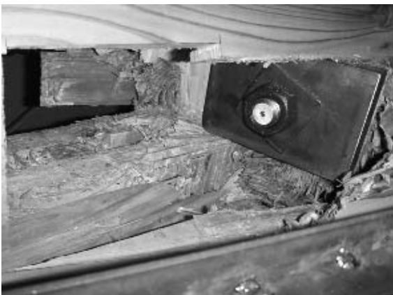
写真 4.4-9 S30B-2 座金下部のめり込み
