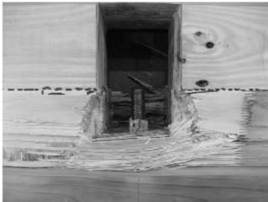
写真 6.4-63 055D-4 解体後 座金下部のめり込み
