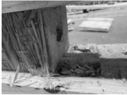
写真 5. 4-38 Mx60APS 1750-6 解体後 座金下部のめり込み
