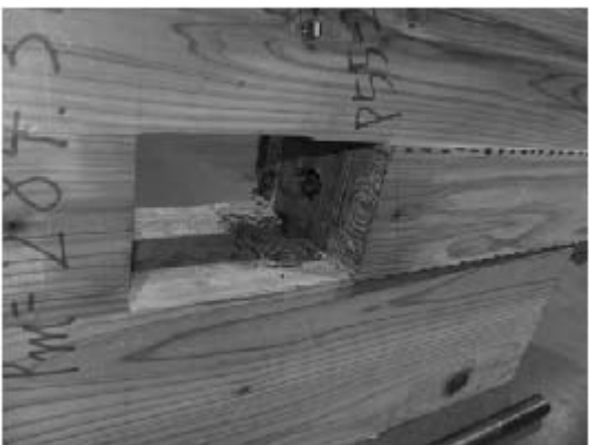
写真 6.4-17 P55-2 座金下部のめり込み
