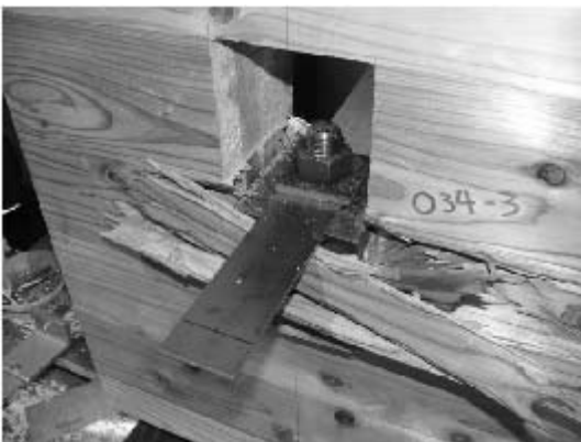
写真 6.4-47 034-3 積層接着面のせん断木部破壊
