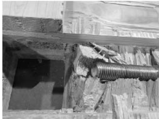
写真 5.4-54 Mx60AOS1540-1 解体後 座金下部のめり込み
