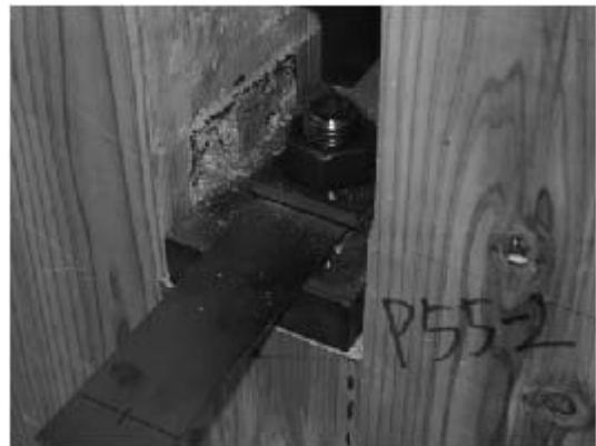
写真 6.4-16 P55-2 座金下部のめり込み
