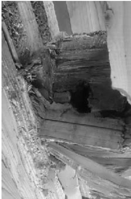
写真 4.4-3 S30A-1 座金下部の めり込み
