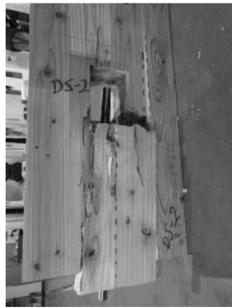
写真 4.4-25 DS-2 積層接着面のせん断 木部破壊
