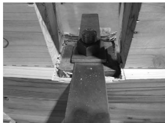
写真 6.4-42 033-6 積層接着面のせん断木部破壊
