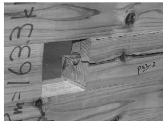
写真 6.4-6 P33-2 外層ラミナ中央部の割れ→ 積層接着面のせん断木部破壊、引張破壊
