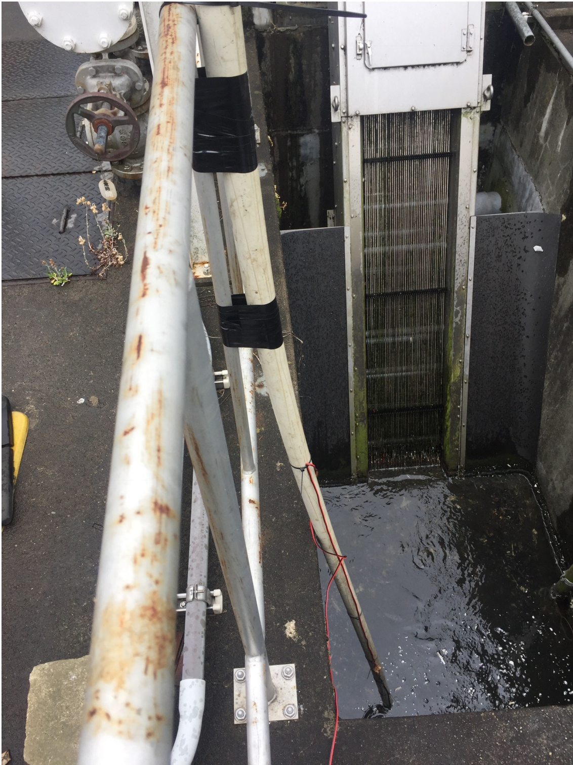
図 15 本排水処理施設の沈砂槽及び設置した温度計の写真
