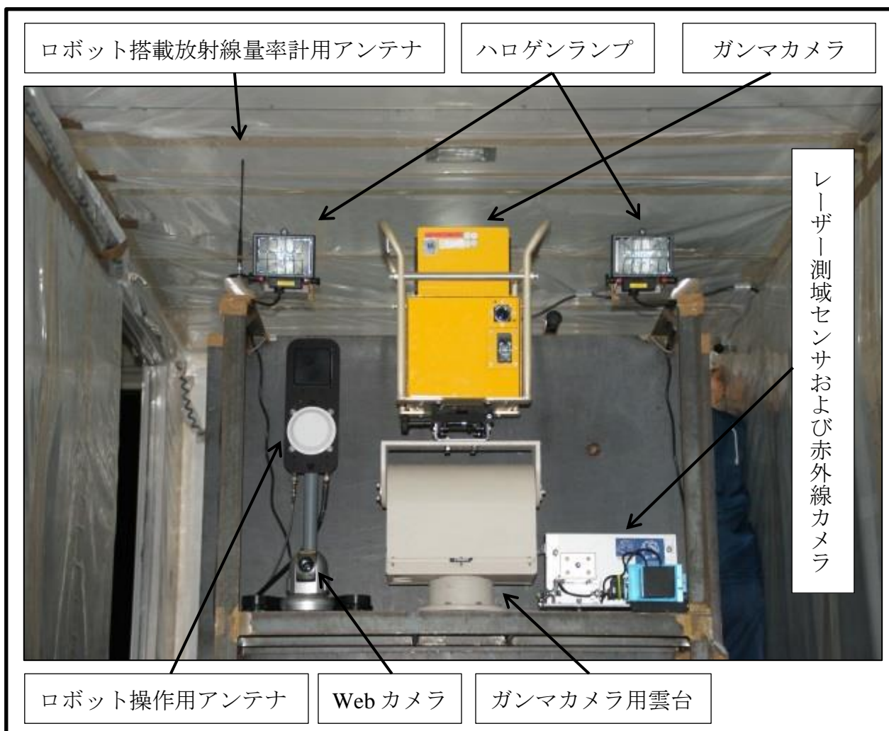
図 4-11 遮蔽操作ボックス前面に配置した機器
