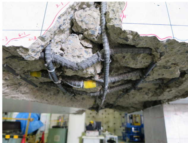
図 5.4.34 橋台鉄筋の破断 ( +7\delta \times 3 回目)
