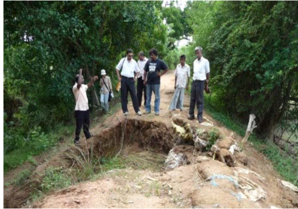
図 3-6 クダプリアンクラマ池の越流箇所
