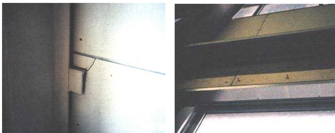
【ボードの割れ】
