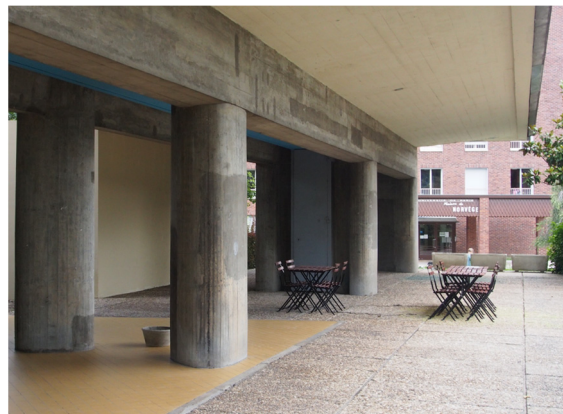
図 3-82 004 スイス学生会館の配管スペース (2014年 筆者撮影) 梁の間(青の蓋)は横引きのPS、柱の間(グレーの蓋)は縦引きのPS
