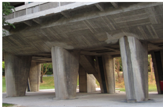
図 3-28 003 マルセイユのユニテ・ダビタシオン（配管スペースが統合された柱脚）
