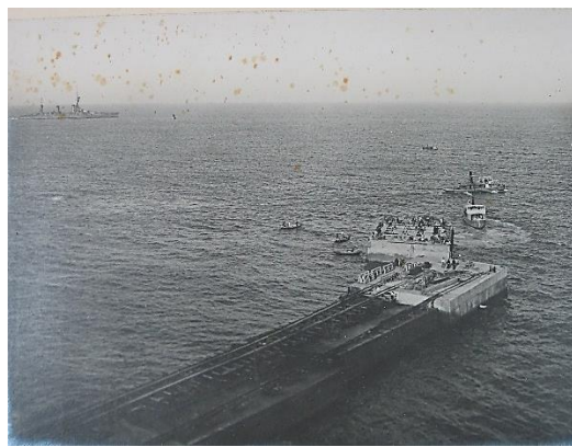
図 31 ケーソンを船で港口に引いて予定地に据付されている作業 (出典：同前掲図)
