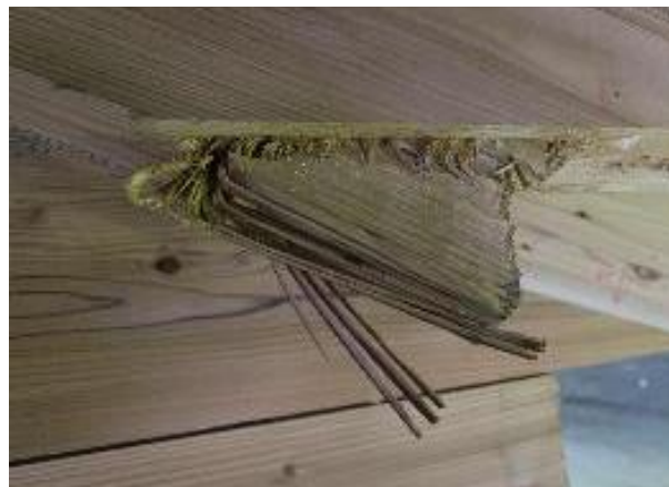
図4- hEWT_12s 試験体 合掌尻登り梁下端部の三角ホゾの始端部の圧壊
