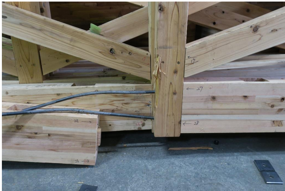
図 5- 陸梁継手の試験終了後の引きボルトの伸びの状況
