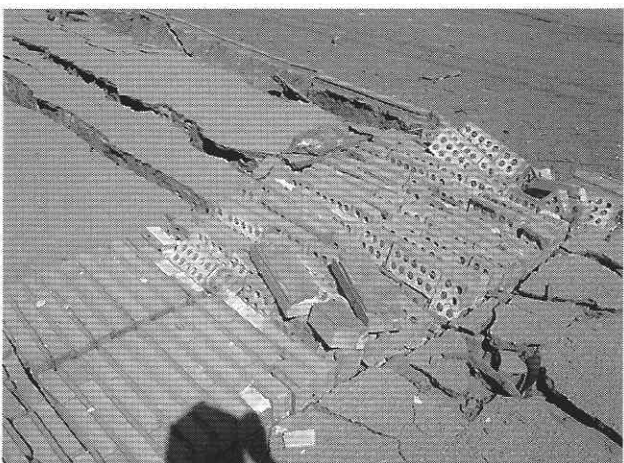
図10 脆弱な目地による壁の一体性の欠如の例
