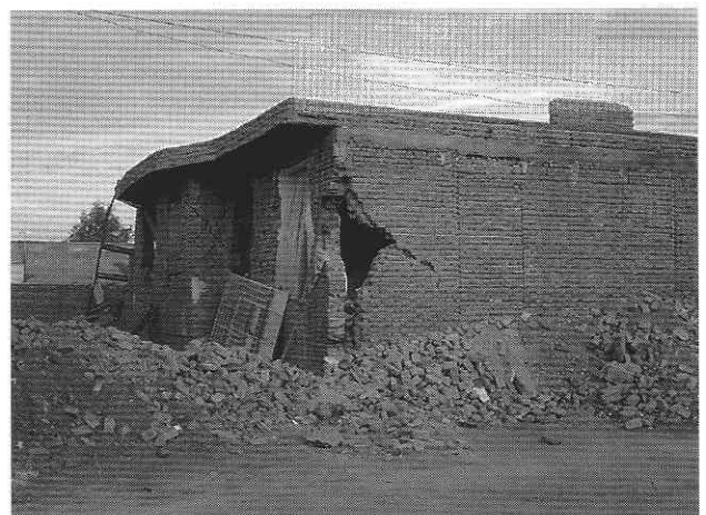
図7 梁だけが施されたタイ付組積造の被害例
