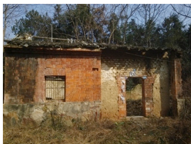
図 43:住宅(土と焼成煉瓦が混在する組積造、×)
