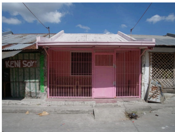
図 3-43 その他 1 (2020 年撮影) -単管パイプで軒が支えられている
