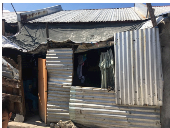
図 3-40 木造の事例 2（2020 年撮影） - 壁資材として金属板（トタン）を使用
