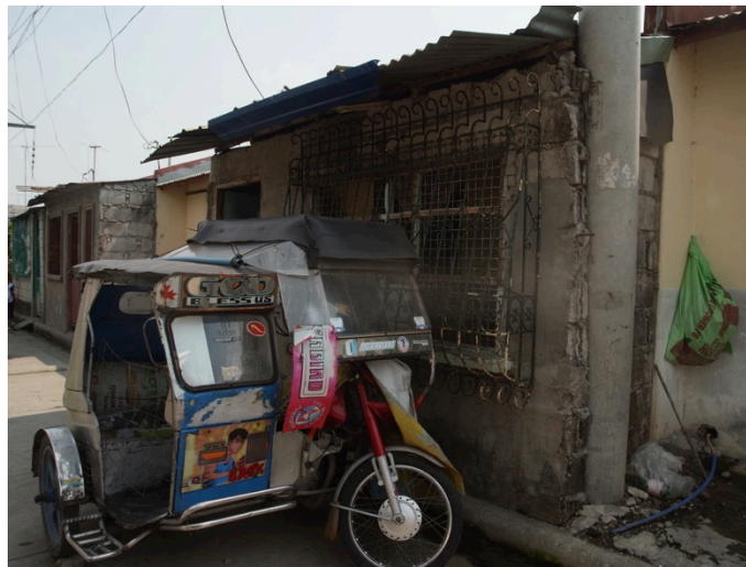
図 3-45 CHB 造、柱・梁なし、電柱により一部切断している事例（2020 年撮影）
