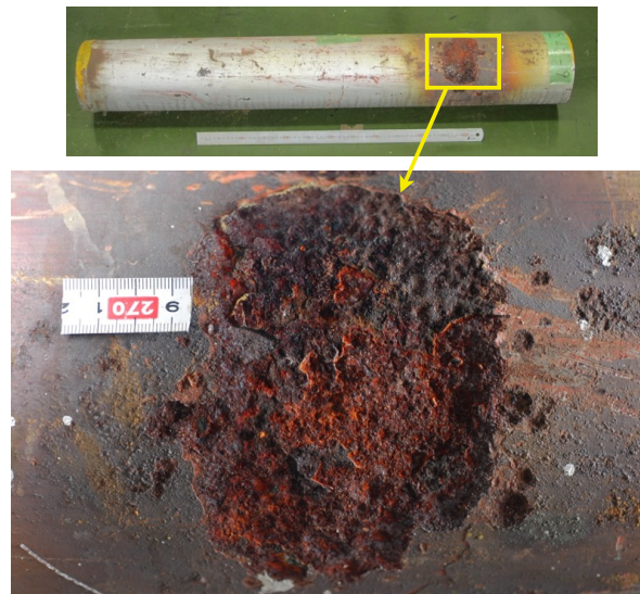
図 1.1: 保温材下腐食の例
