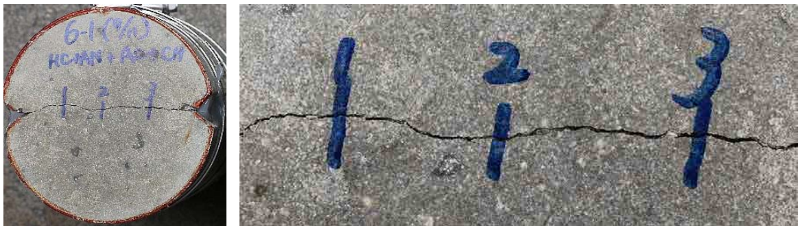
写真 7.3 通水試験前の No.4 (G-A-C+G-B-C) の円柱供試体底面のひび割れ部
