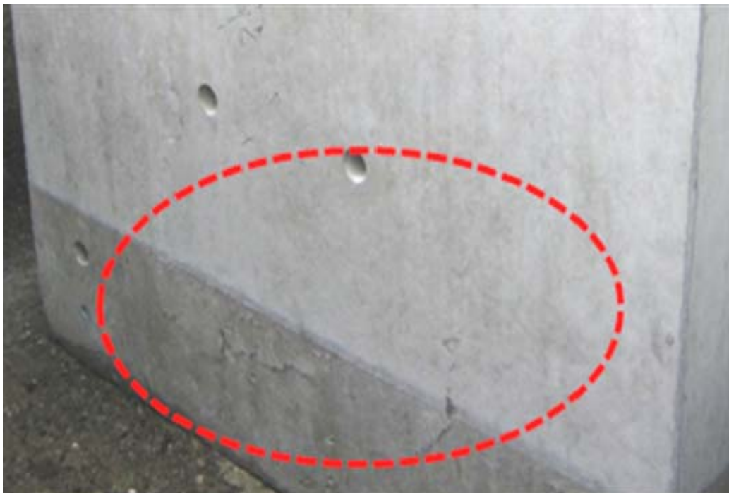
写真 4. 15 Type-1A の桁形 RC 試験体の押し抜き損傷部（ひび割れ導入時に損傷）
