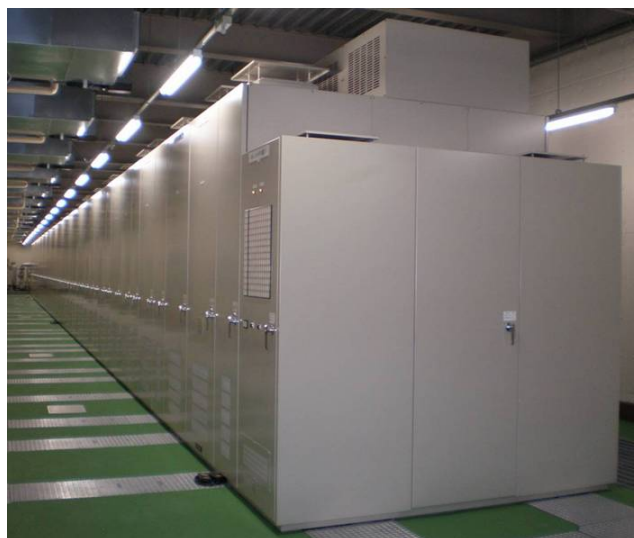
図 8. 2. 2 EFC の変換器外観 (30 MVA-1 系分)
