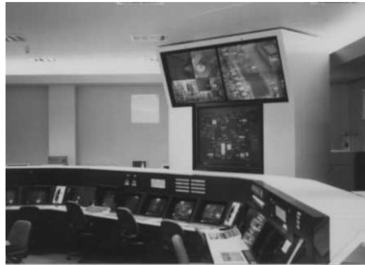
図 1.4 Recent plant control room （出典：[1]）
