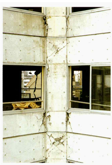
写真2.1 RC造9階建ての集合住宅に生じた柱梁接合部の損傷 [2.2]
