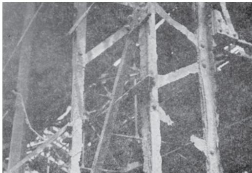
図 1.2.2.1 ラチス柱のガス腐食による欠損
