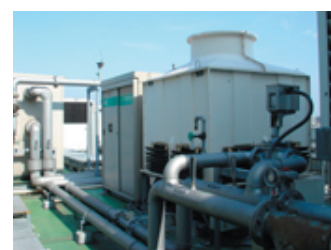
屋上に設置された省エネ設備機器
