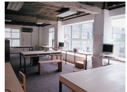
改修後3階内観 床・天井は躯体を露出 天井にはジャンカ等も見られる
