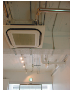
re-know 改修後内観 配管を見せる設備機器
