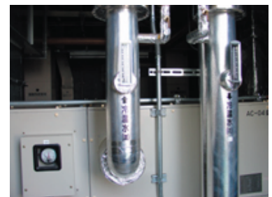
高効率な空調設備機器
