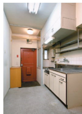
既存住戸内 老朽化・陳腐化したキッチンの設備
