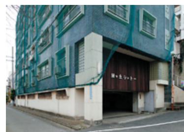
改修前外観 劣化したタイル落下の危険を防ぐネット
