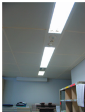
高効率照明機器・照度センサー
