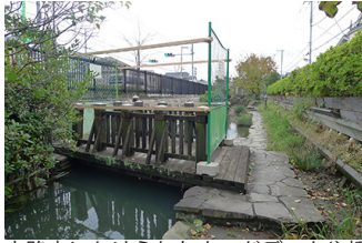
水路内にかげられたウッドデッキや橋はメンテナンスが行き届いていないものが多い
