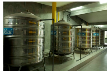
図 3-32 事例 Z 雨水タンク 出典:設計者提供
